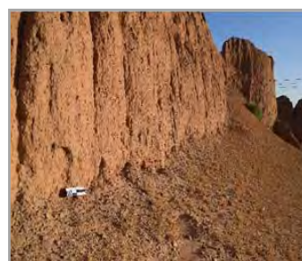
آسیب در پای دیوار تاریخی
