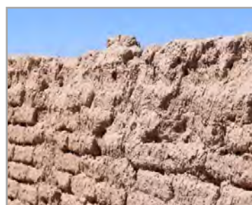
آسیب در رأس دیوار بازسازی‌شده
