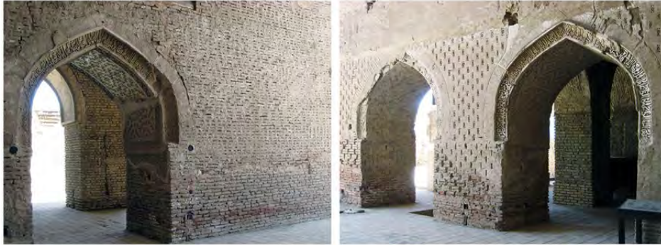
تصویر ۲۶: تفاوت در نوع آجرکاری در دو پایه شرقی (راست) و غربی (چپ) ایوان جنوبی
