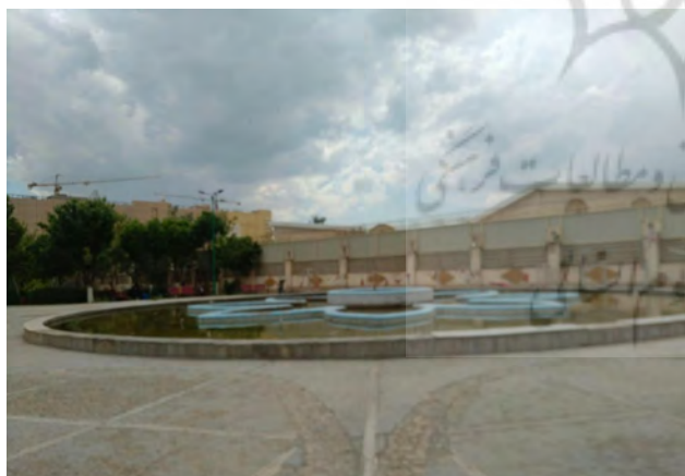
تصویر ۱۵. بهسازی آب‌نما در امتداد مسیر احداث آلاچیق‌ها و سرد اصلی پارک. عکس: سیدمحمدعلی محمدی، ۱۳۹۹.
