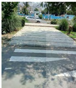
تصویر ۱۰ - کفسازی و اختلاف ارتفاع نامناسب
