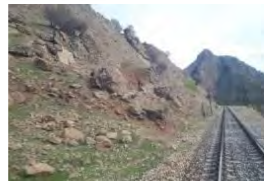
ترانشه ناپایدار کیلومتر ۴۲۶+۵۰۰
