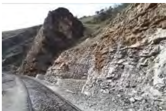
ترانشه ناپایدار کیلومتر ۵۱۸+۷۰۰
