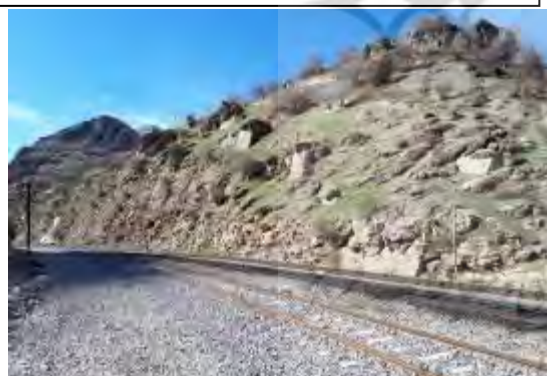
ترانشه ناپایدار کیلومتر ۴۷۹+۱۰۰
