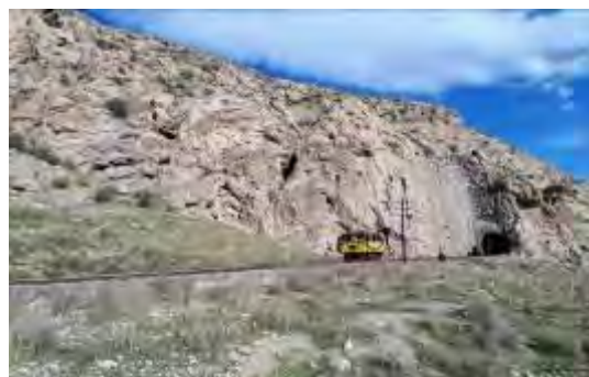
ترانشه ناپایدار کیلومتر ۴۷۶+۵۰۰
