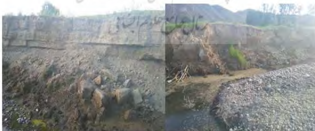
شکل ۱۰: زیر بری رودخانه و ریزش دامنه در طبقات حساس به فرسایش، شکل ۱۱- کناره رسی-سیلنتی به شدت فرسایش پذیر و تخریب گسترده باغات
