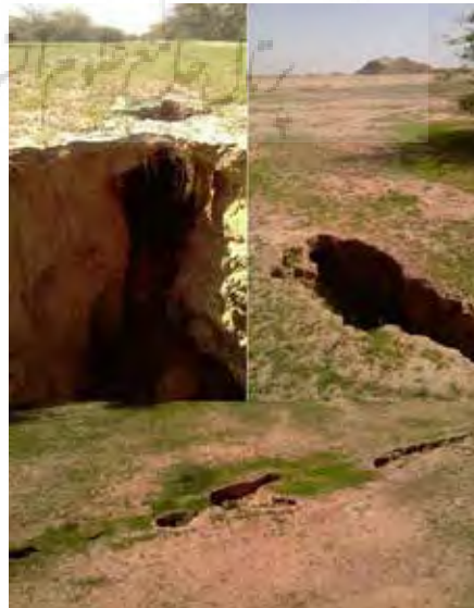
تصویر ۳: نحوه تکامل درزه‌ها و تبدیل شدن آن‌ها به حفره و درنهایت، کانال آب
