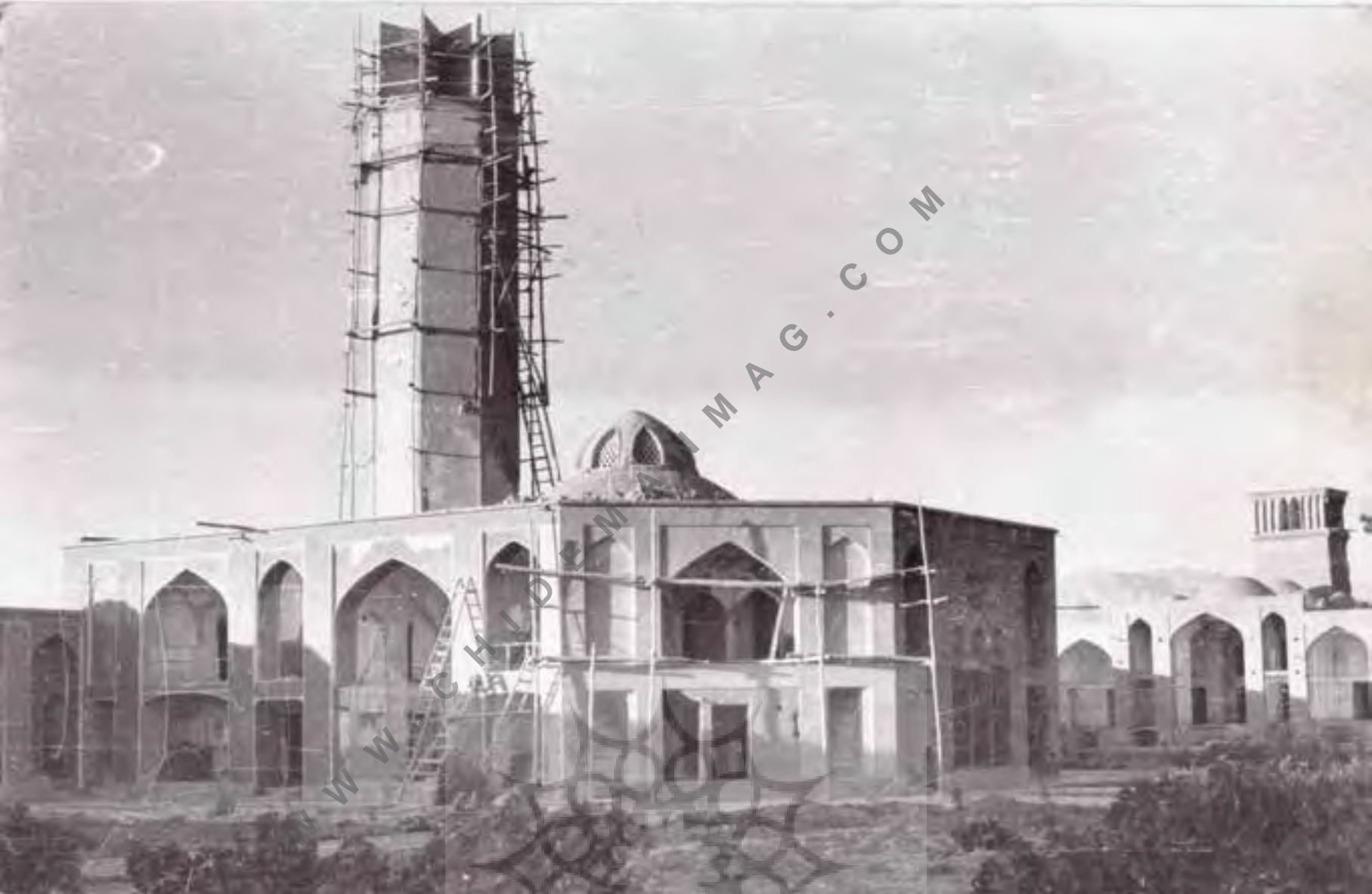
بادگیر باغ دولت آباد در دست مرمت-نمای باغ دولت آباد دهه-۵۰؛ منبع: آرشیمیراث فرهنگی
