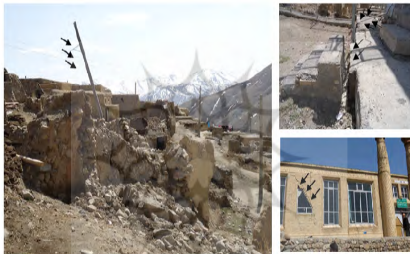
شکل (۲) تصاویری از تخریب ساختمان‌های روستای گوگرد در اثر زمین لغزش
