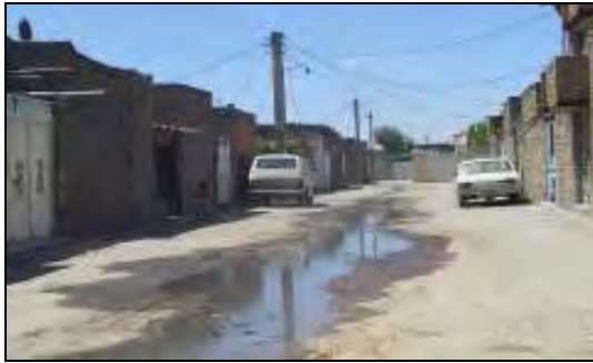
شکل ۱۳- عدم سهولت دسترسی در برخی مسیرهای پیاده به دلیل سطح نامناسب (بهارستان پایین)
