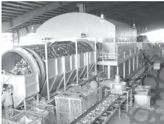
یکی از خطوط پردازش در مجتمع پردازش و دفع آرادکوه
