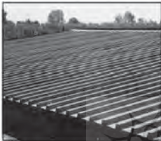
شکل ۶- پانل های دیوار خورشیدی که روی پشت بام ساختمان خشک کن قرار گرفته اند (w.GPEKsconstruction)
