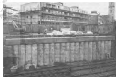
تصویر ۴- پایدار سازی دیواره گودبرداری از داخل - روش اجرای شمع در جا. (مأخذ: Puller, 2005.)
