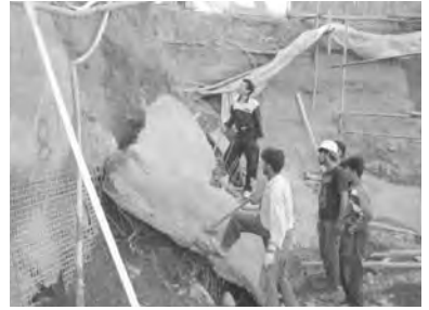
تصویر ۲۰- روش میخ کوبی - رانش پوسته بتنی قسمت آزاد بالای اولین ردیف میخ‌ها، (مأخذ: نگارنده)
