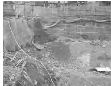
تصویر ۲۱- روش میخ کوبی - رانش پوسته بتنی و تخریب پیاده رو و تأسیسات زیر بنایی مجاور سایت. (مأخذ: نگارنده)
