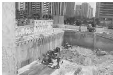
تصویر ۳- پایدار سازی جداره گودبرداری از داخل و خارج گود- روش دیافراگم و دیافراگم و انکراژ. (مأخذ: نگارنده)
